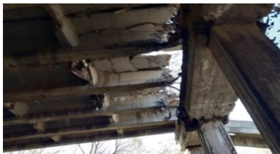
Рисунок 2 – Повреждения мостовых конструкций при взрыве
