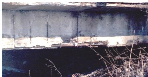
Рисунок 1 – Повреждения конструкций эксплуатационного характера
